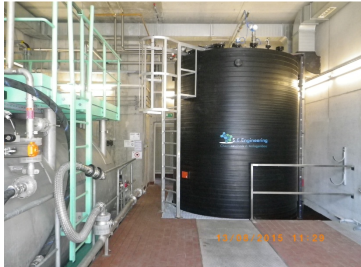
Lagerhalle mit neuem (rechts) und Bestands tank (links)
