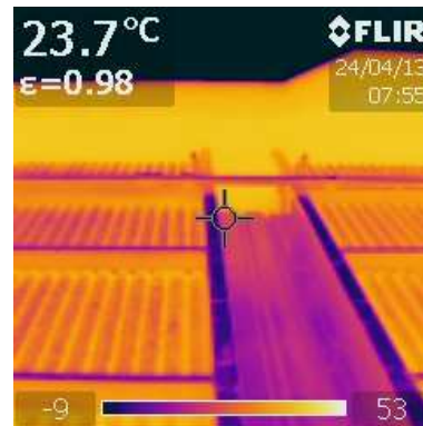
Thermobild LuKo nach AK nach Umbau
