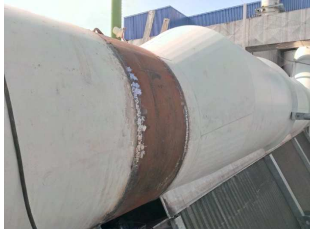
Betroffene Stelle im Abdampfrohr nach Ausbau der AK
