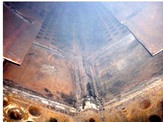
Passtück an Stelle der AK im Dampfverteiler
