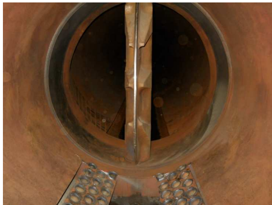
Absperrklappe im Dampfverteiler © GfA A. d. ö. R.
